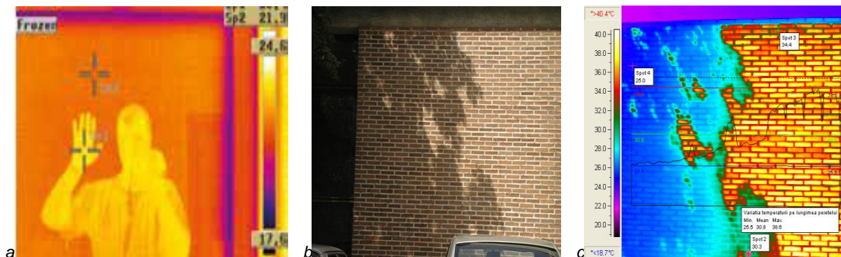
Fig. 3. Dificultăți tipice în inspecția termografică: a. – la examinarea unei uși metalice, imaginea operatorului cu camera detectoare este reflectată; b. – imaginea în vizibil a unui perete pe care se proiectează umbra unui copac; c. - imaginea în infraroșu a peretelui din imaginea b, complicată din cauza umbrei.
